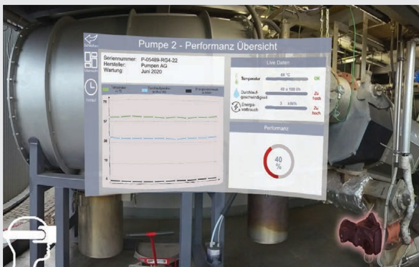
Abbildung 3: Der Blick durch die VR-Brille zeigt die Anlage mit Betriebsdaten im Prototyp.
