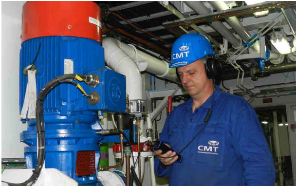
Foto 2: Mit dem Vibration Meter frühzeitig Schäden erkennen © CM Technologies GmbH
